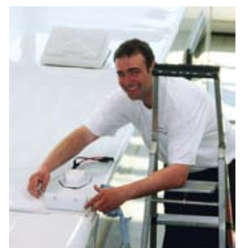
Der Deckendurchlass verschwindet geschickt unter der Solaranlage.
